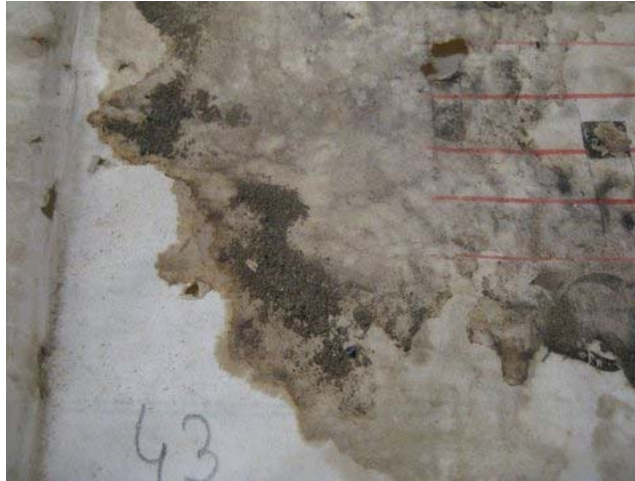
Manchas y suciedad con residuos sólidos.
